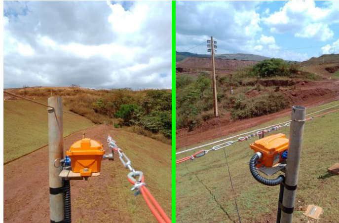
Figura 5.10 – Cordões de emergência
