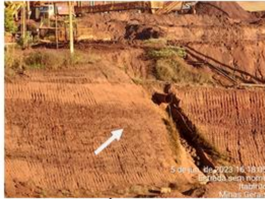
Figura 4-11: Água pluvial da estrada principal interna SAFM sendo direcionada para a cava do dique.
