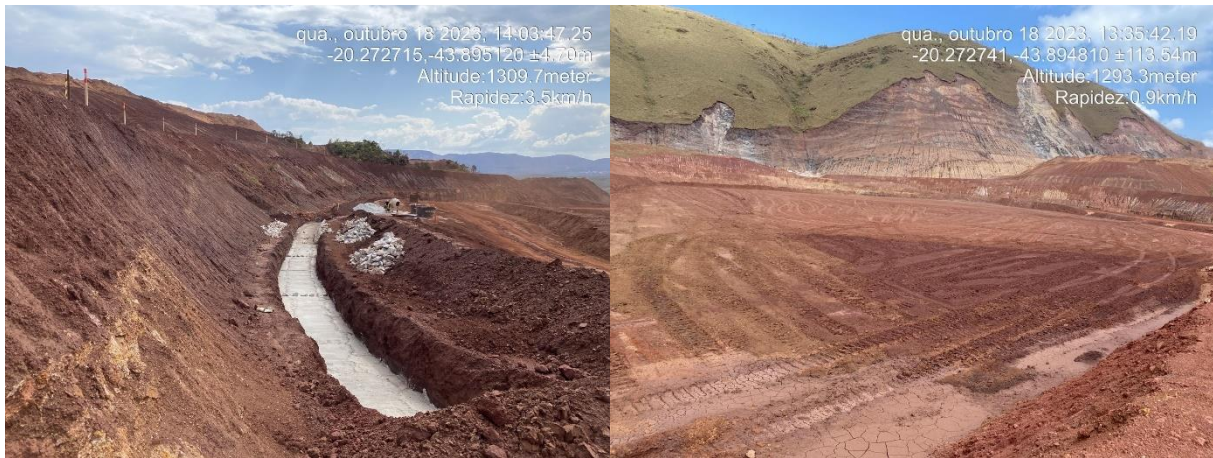
Figura 6-34: Condição e preparo para o período chuvoso da Barragem Central no trimestre
