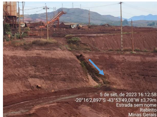
Figura 6-48: Água pluvial da estrada principal interna SAFM sendo direcionada para a cava do dique.
