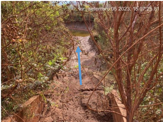
Figura 6-45: Direcionamento da água pluvial da ITA 320 para um sump.
