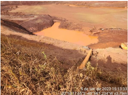
Figura 6-40: Encanamento direcionando a pluviometria da estrada para a cava do dique.
