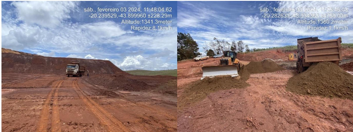
Figura 6-14: Espalhamento, compactação, teste de hilf e proctor e acompanhamento diário da estrutura referente a este relatório
