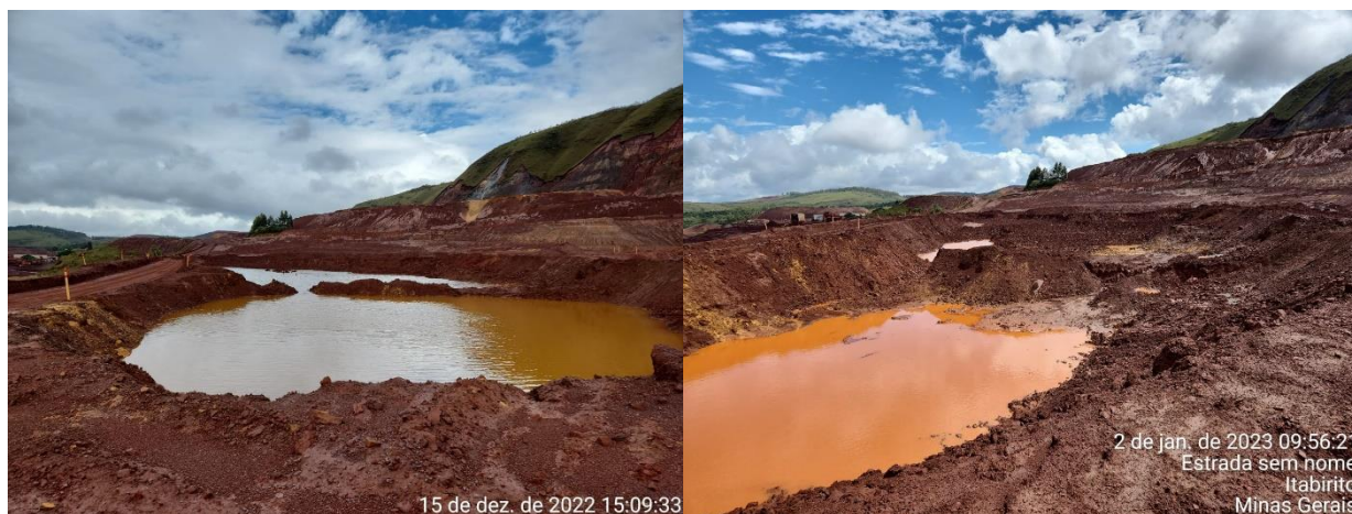
Figura 7-2: Sump funcionando durante o período chuvoso
