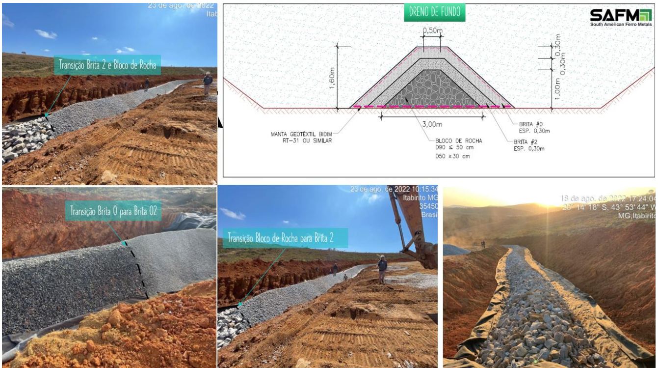
Figura 7-1: Etapas construtivas aderente ao projeto executivo do dreno de fundo da pilha noroeste.
