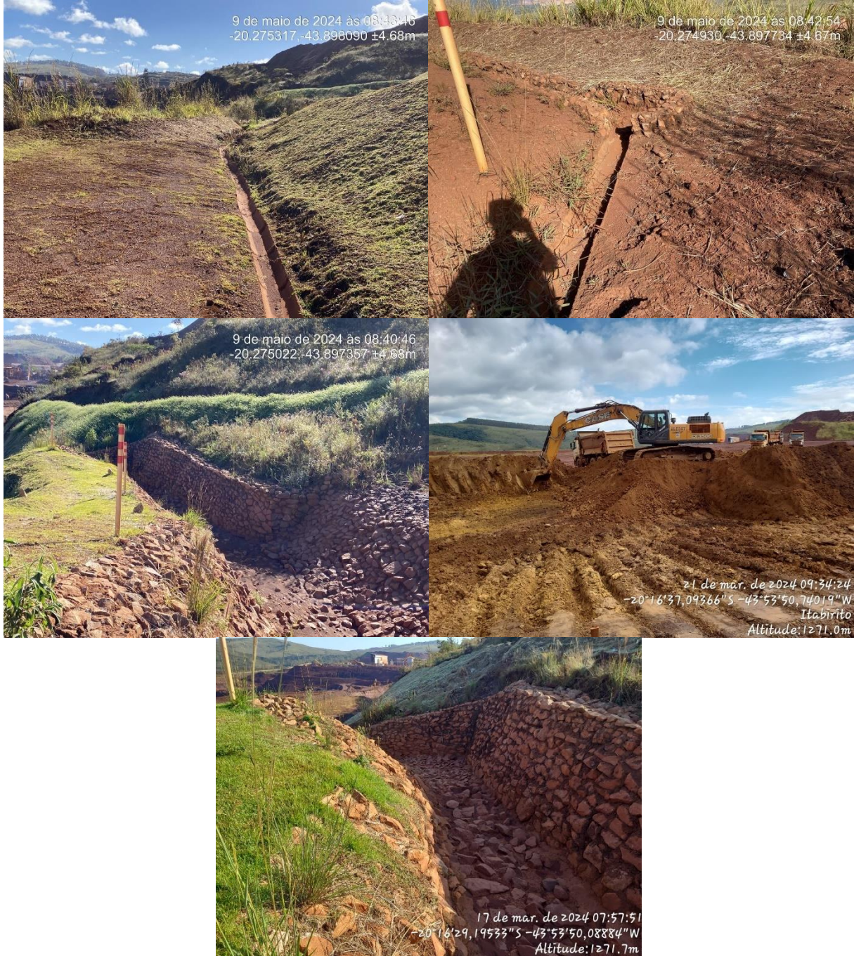
Figura 6-31: Fotografias do sistema de drenagem da Barragem Aredes ao longo do trimestre
