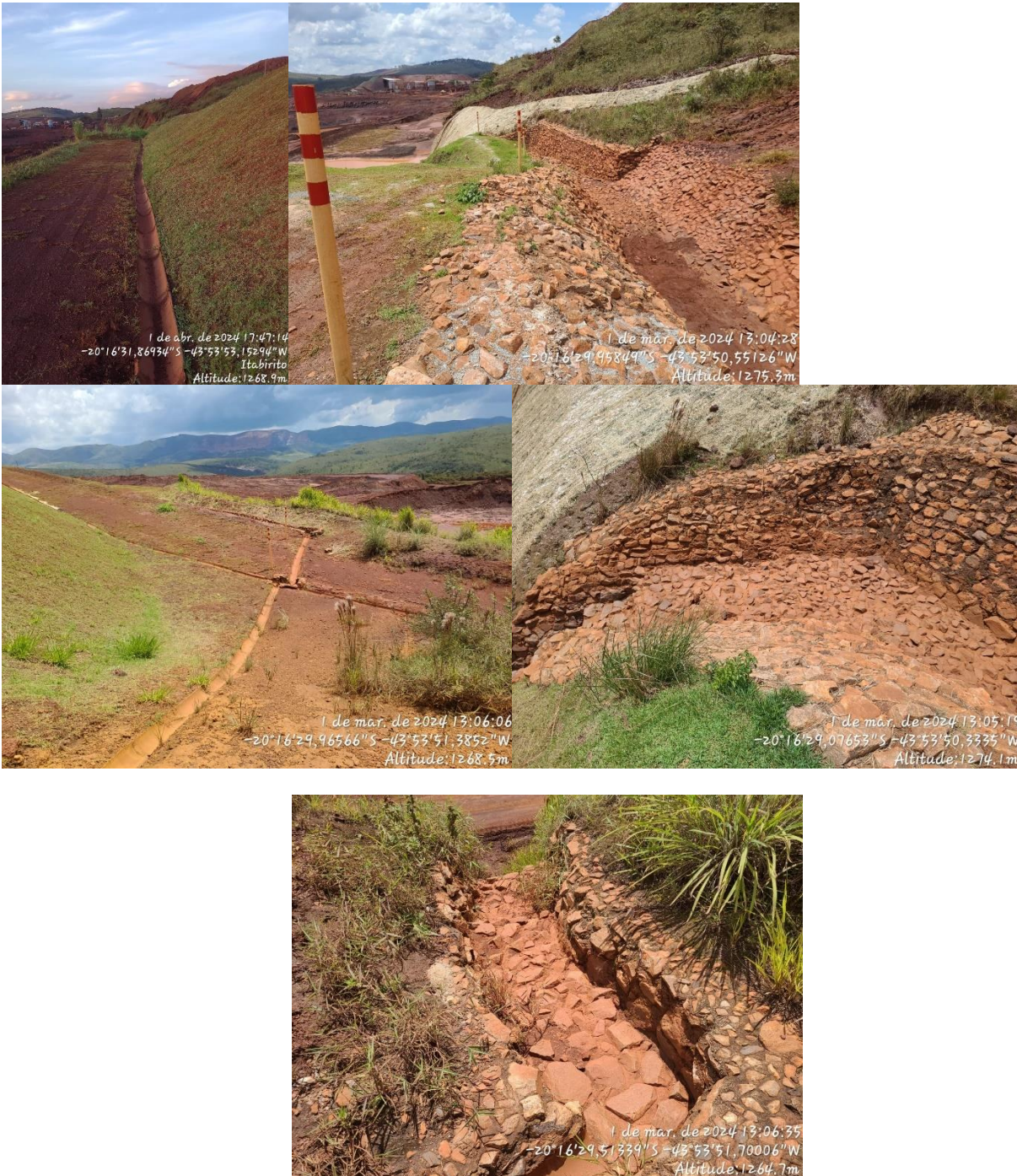
Figura 6-51: Drenagem superficial na Barragem Aredes
