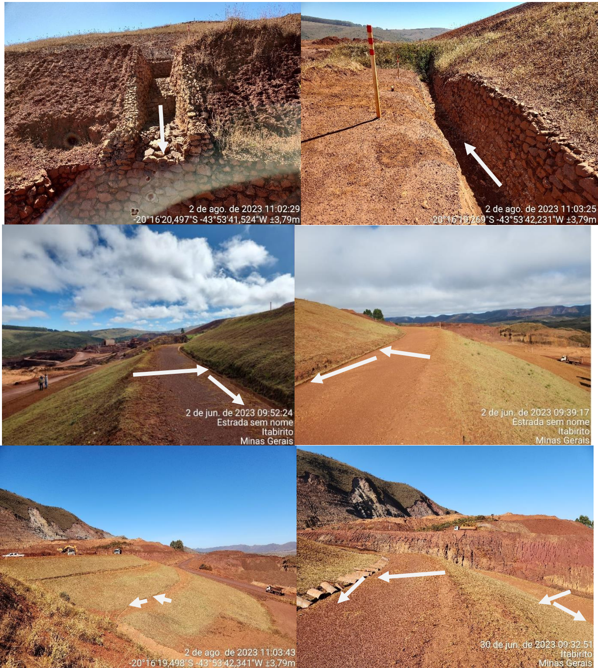
Figura 6-49: Drenagem na barragem Central.
