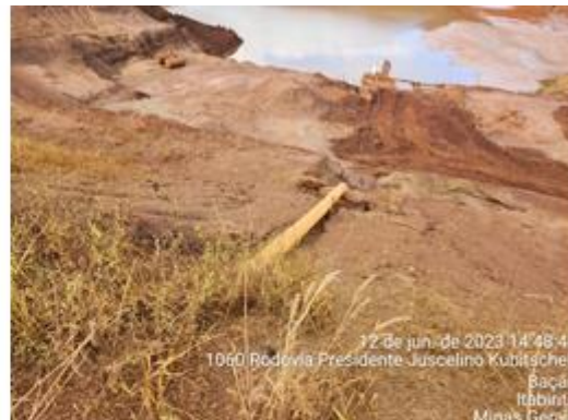
Figura 4-7: Encanamento direcionando o fluxo de água da estrada para a parte interna da SAFM Mineração.
