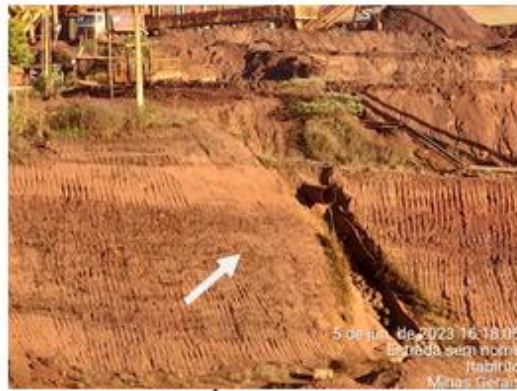
Figura 4-11: Água pluvial da estrada principal interna SAFM sendo direcionada para a cava do dique.
