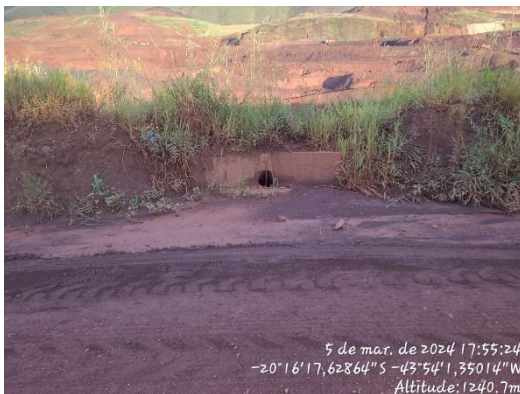
Figura 6-48: Encanamento direcionando a pluviosidade da estrada para a cava do dique.
