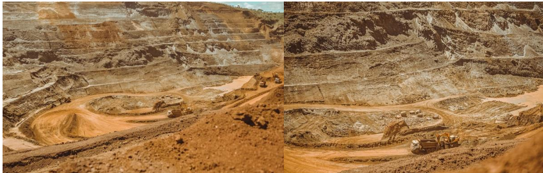
Figura 6-52: Cava sul. Sump para onde a água da barragem Aredes é desviada.
