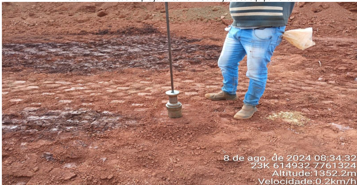
Foto 17: ensaio para determinação de umidade in situ e grau de compactação (Hilf). Componentes: haste guia, martelo de cravação, cabeçote metálico e cilindro biselado.
