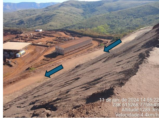
Figura 6-41: sistema de drenagem (Pátio de Vendas).
