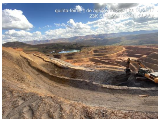
Figura 6-50: Cava sul. Água pluvial sendo retirada do fundo da cava para aspersão de poeira interna.
