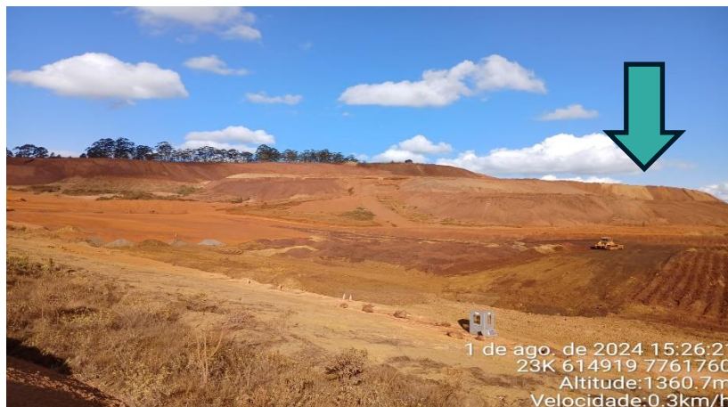
Foto 08: bota-espera de rejeito grosso na Praça 07.
