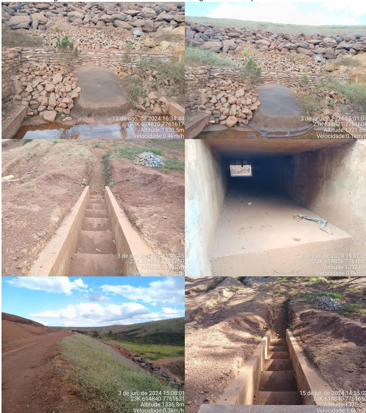
Figura 6-9: Monitoramento da vazão da drenagem interna da pilha noroeste
