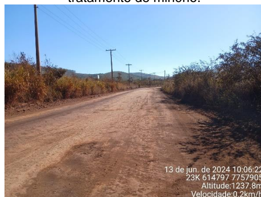
Figura 6-46: ITA-320. condição atual da estrada.
