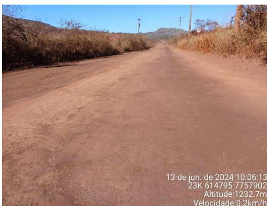
Figura 6-44: condições da ITA-320.
