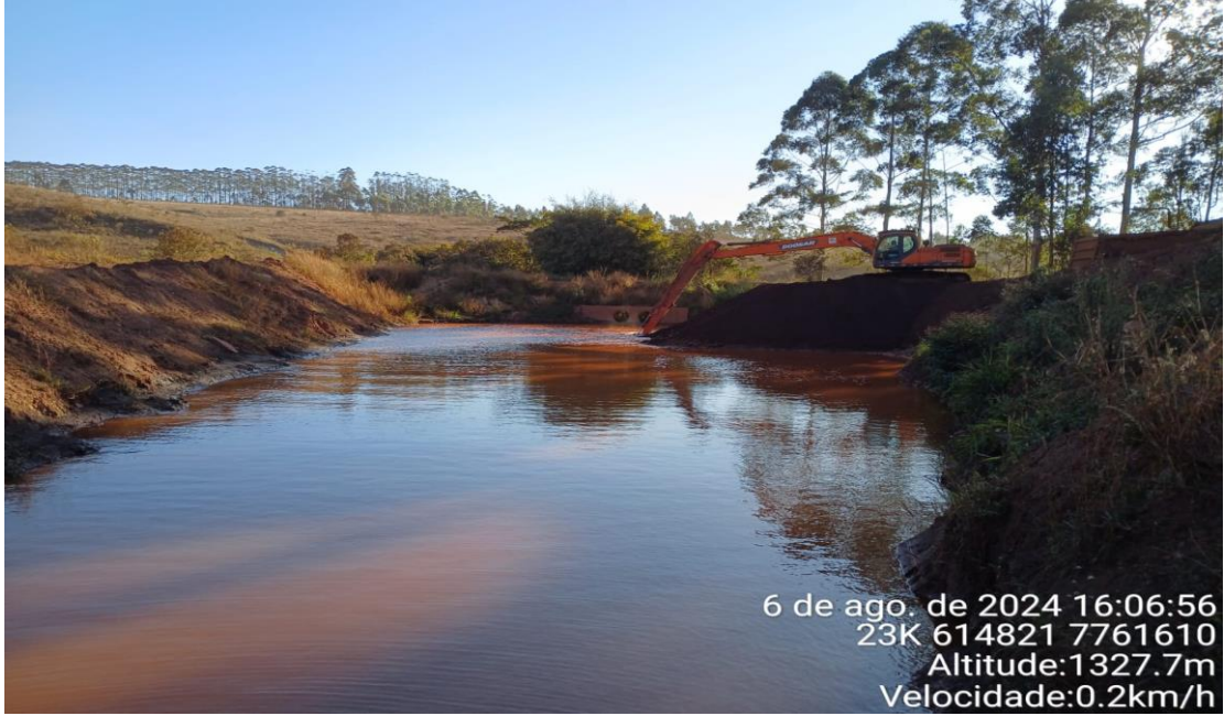
Figura 13: Sump limpo e desobstruído.
