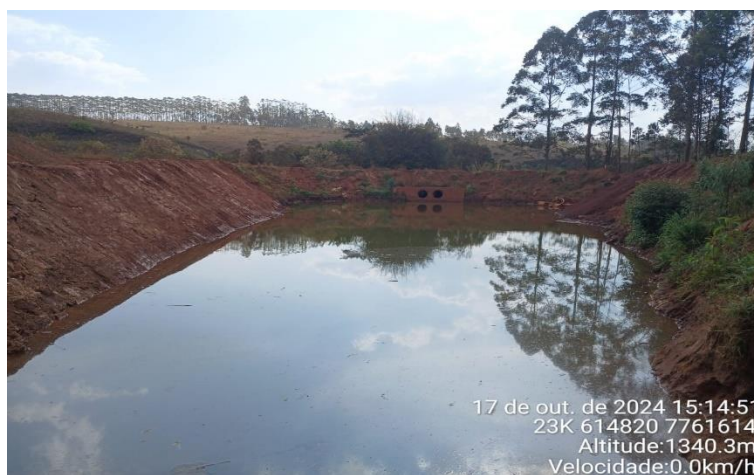
Figura 13: Sump limpo e desobstruído.
