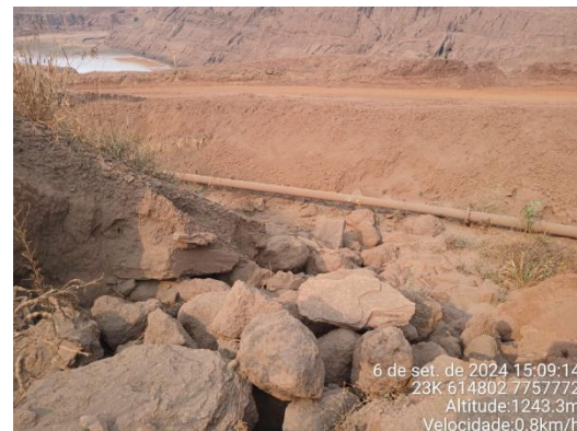
Figura 6-49: Outro ponto da ITA-320 que conduz água pluvial para o fundo da cava do dique.
