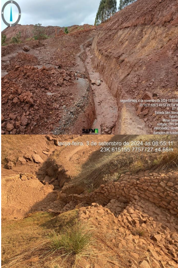
Figura 6-32: Fotografias do sistema de drenagem da Barragem Aredes ao longo do trimestre.
