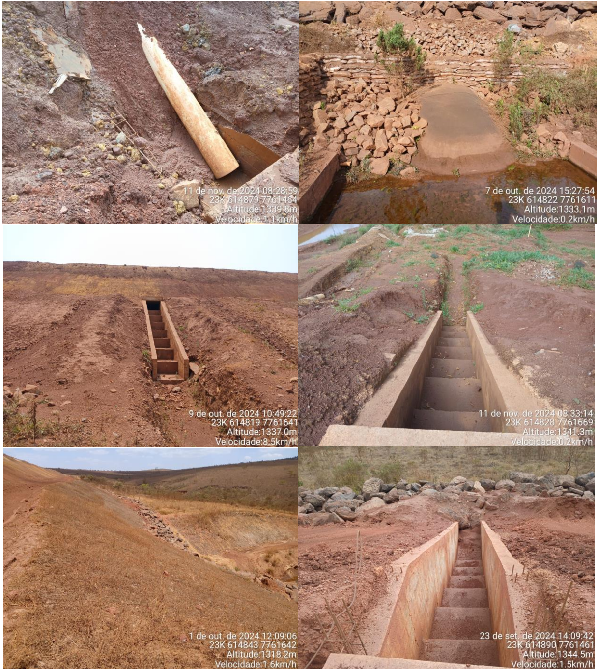
Figura 6-5: Monitoramento da vazão da drenagem interna da pilha noroeste
