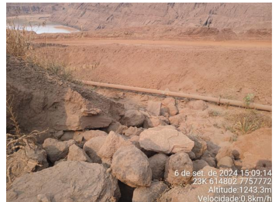
Figura 515: Outro ponto da ITA-320 que conduz água pluvial para o fundo da cava do dique.
