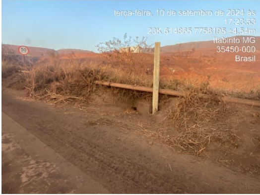
Figura 517: Bueiro que sai da ITA-320 para o fundo da cava do dique.
