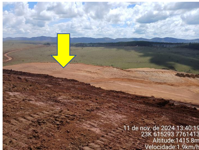
Foto 08: bota-espera de rejeito grosso na Praça 07.
