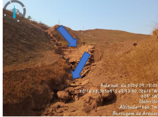
Figura 518: Saída da drenagem do extravasor principal da Barragem Aredes para o dique a jusante.
