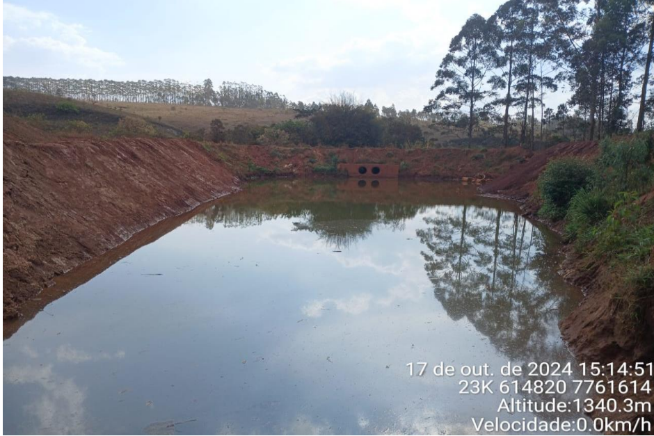
Figura 9: Sump limpo e desobstruído.
