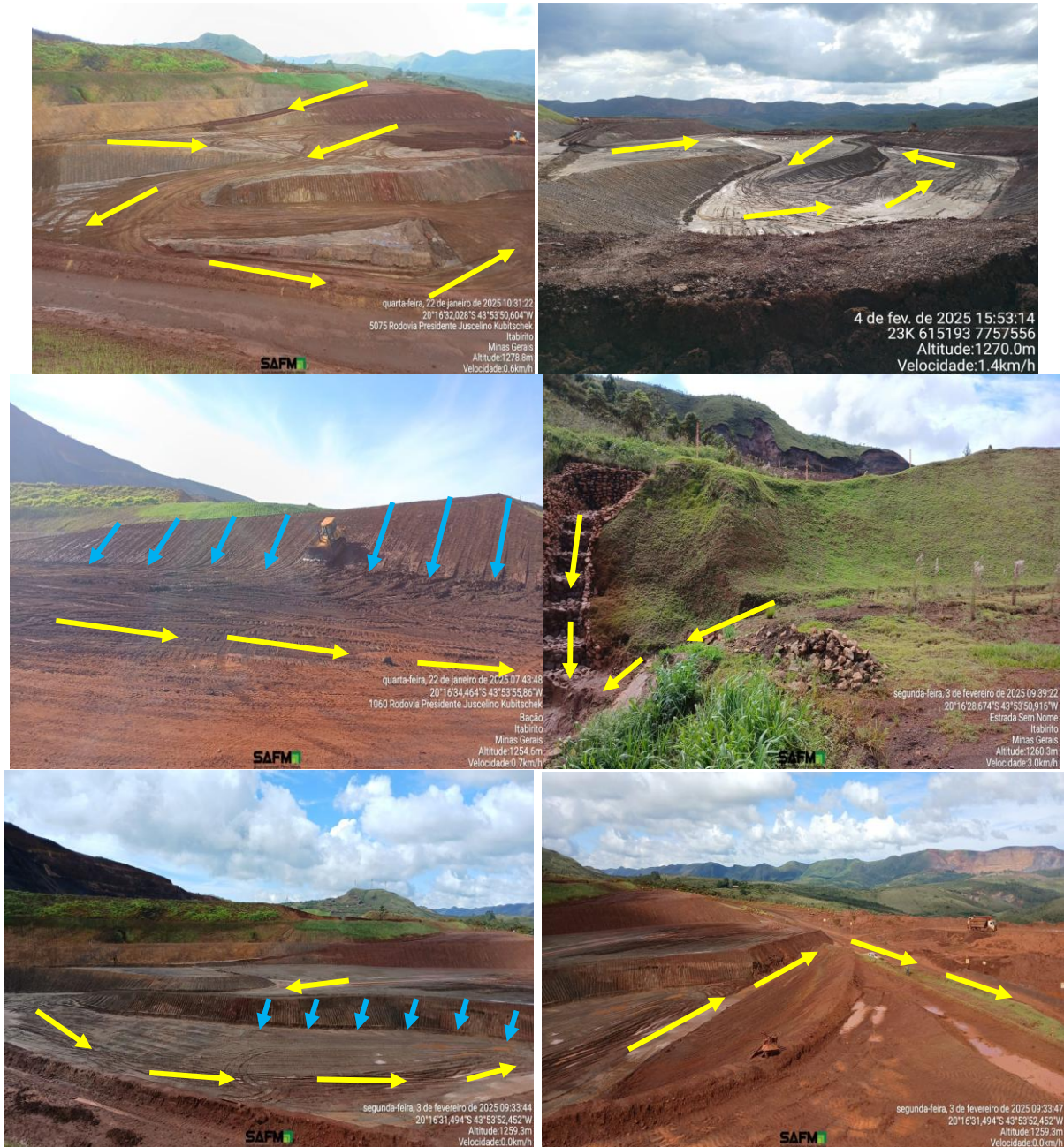
Figura 6-13: Direcionamento da água para saída da antiga estrutura da Barragem Aredes para cava a jusante por intermédio do redutor hidráulico.
