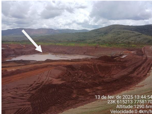
Figura 6-42: Local onde existia o dique longitudinal e atualmente é o fundo da cava do dique.
