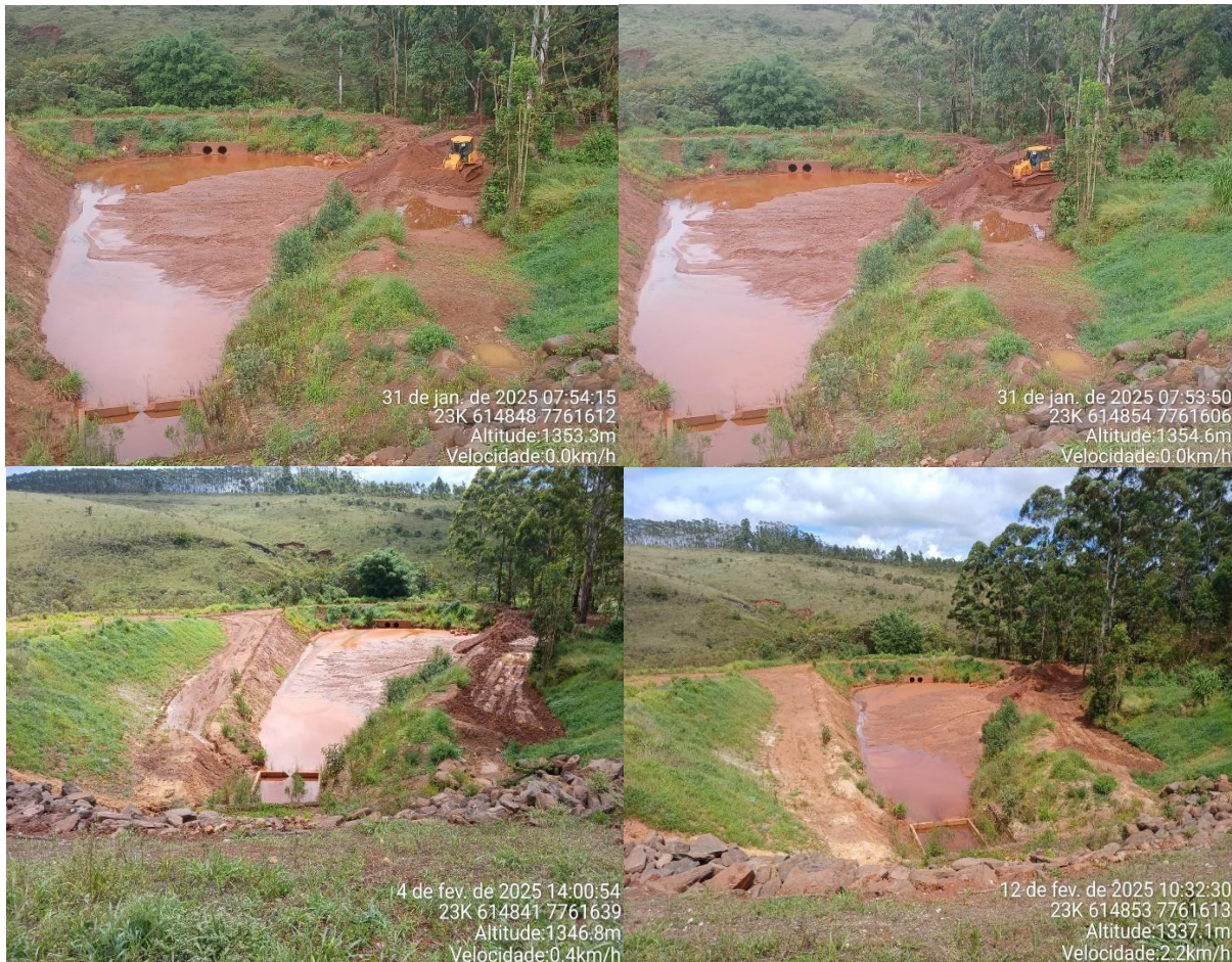
Figura 612: sump e dreno de fundo com saída de água límpida– Pilha Noroeste.
