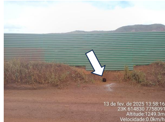
Figura 6-45: Ponto de desagüe da ITA-320 com tubulação que direciona água para jusante na cava do dique.
