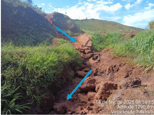
Figura 6-53: Saída da drenagem do extravasor principal da Barragem Aredes para o dique a jusante.
