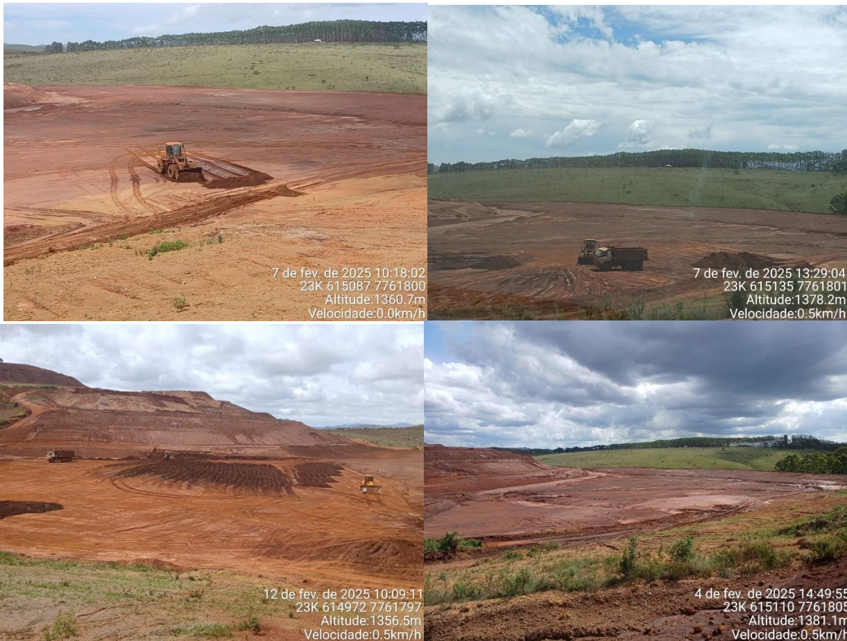
Figura 6: situação de momento da praça com controle e o início do processo de preparação para o alteamento a ser realizado na próxima estiagem.
