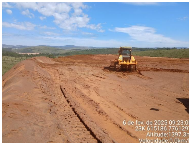
Foto 17: bota-espera de rejeito grosso na Praça 07.
