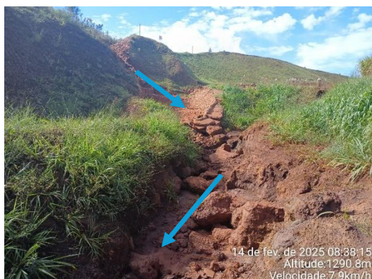
Figura 6-48: Saída da drenagem do extravasor principal da Barragem Aredes para o dique a jusante.
