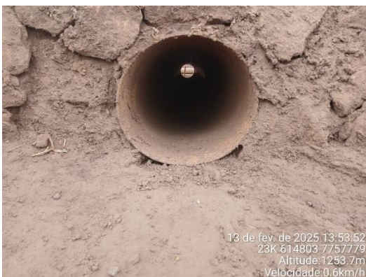
Figura 6-45: Entrada de um dos tubos oriundos da ITA-320 que desembocam na
