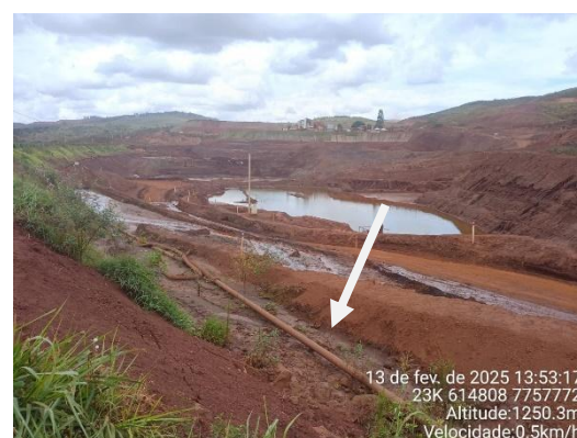
Figura 6-36: Encanamento direcionando a pluvimetria da estrada para a cava do dique.
