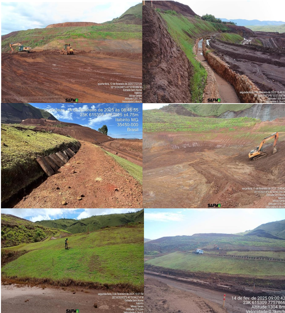
Figura 32: manufatura dos sistemas de drenagem da Barragem Central ao longo do trimestre.
