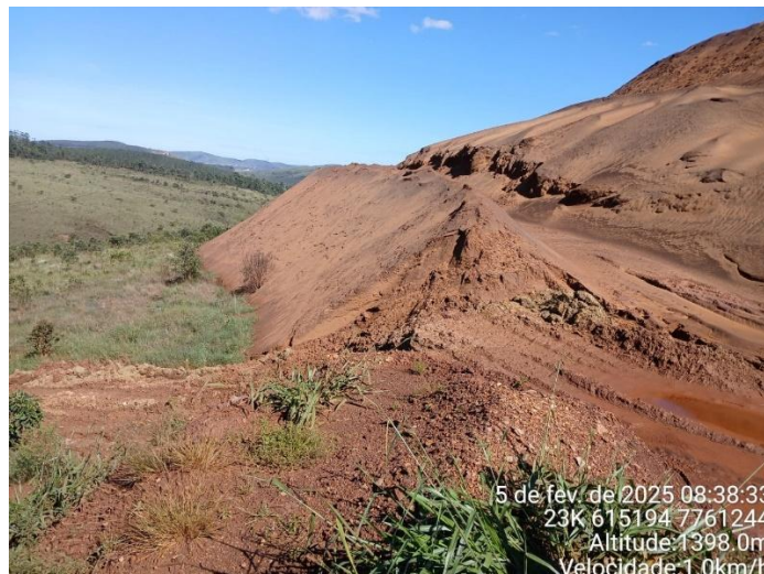
Foto 08: bota-espera de rejeito grosso na Praça 07.
