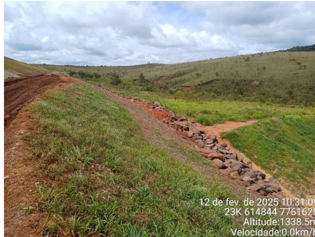
Foto 25: desenvolvimento vegetativo da hidrossemeadura na face do talude (cotas: 1330m a 1340m.).
