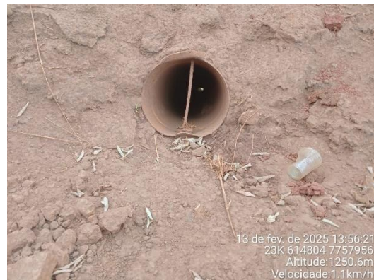
Figura 6-47: Tubo que sai da ITA-320 para o fundo da cava do dique com proteção de sedimentos.
