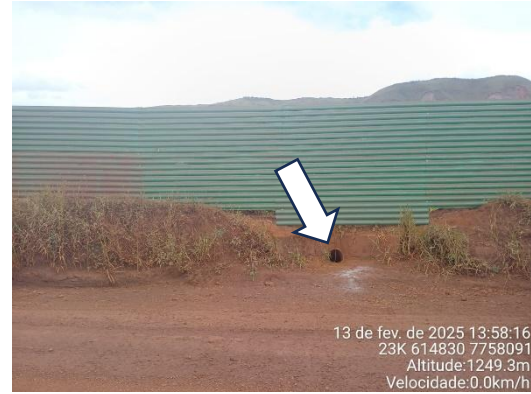
Figura 6-40: Ponto de desague da ITA-320 com tubulação que direciona água para jusante na cava do dique.
